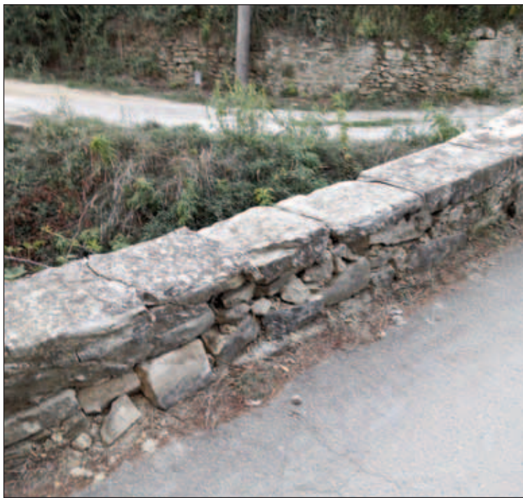
La spalletta smossa
